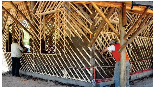
Construcción de la oficina de turismo municipal de Coronel Belisle, Río Negro en el marco de un proyecto participativo y capacitación teórico práctica a personal municipal y vecinos.
