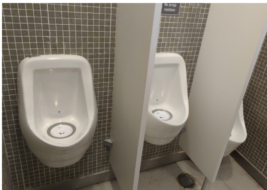
Urinarios secos públicos instalados en una estación de servicios de Buenos Aires.
