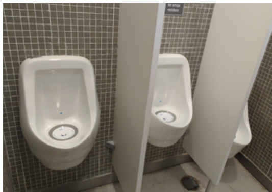
Urinarios secos públicos instalados en una estación de servicios de Buenos Aires.
