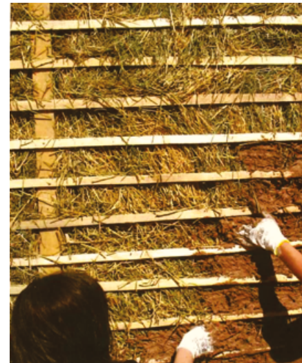
Revoque de carga sobre quincha seca con listones horizontales. Fuente: Arq. Gernot Minke.
