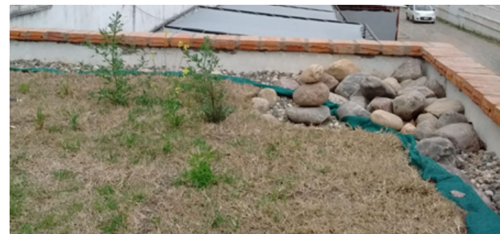
Detalle de drenaje con malla plástica y filtro de piedras. Fuente: Estudio Van-Gross.
