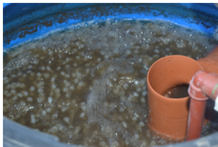
Sistema MBBR funcionando en el interior de un tanque.
