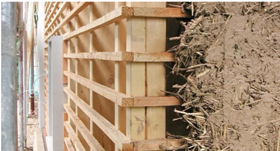
Relleno de fachada de tierra-paja con un espesor de 29 cm y una densidad de 1000 kg/m 3 en Darmstadt, Alemania (año 2012). Arquitectos Schauer + Volhard.
